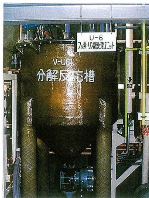
写真4 フッ素・リン酸系廃液反応槽
