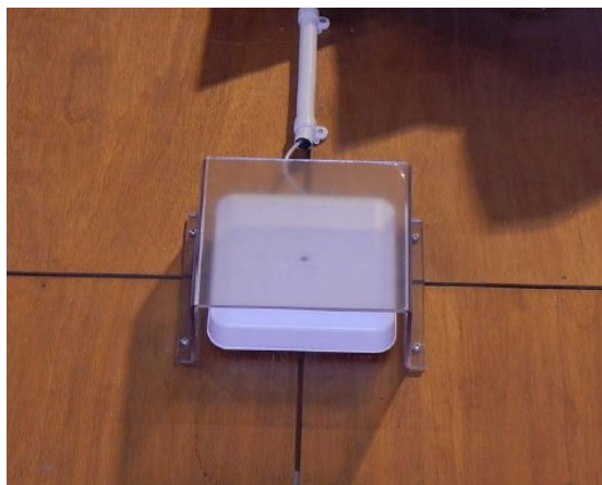
図 2 無線 LAN アクセスポイント設置状況 (大体育館アリーナ)
