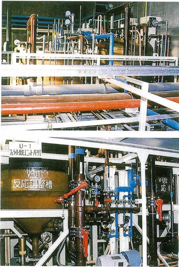
写真1 COD反応調整槽(左) 及びフェライト反応塔(右)
